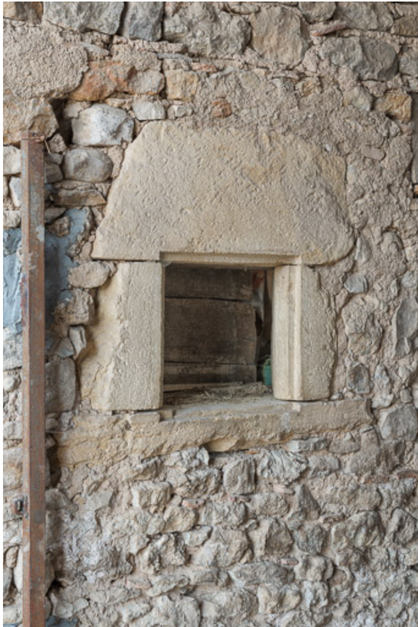
Feuron percé dans le mur entre la remise et l'étable
