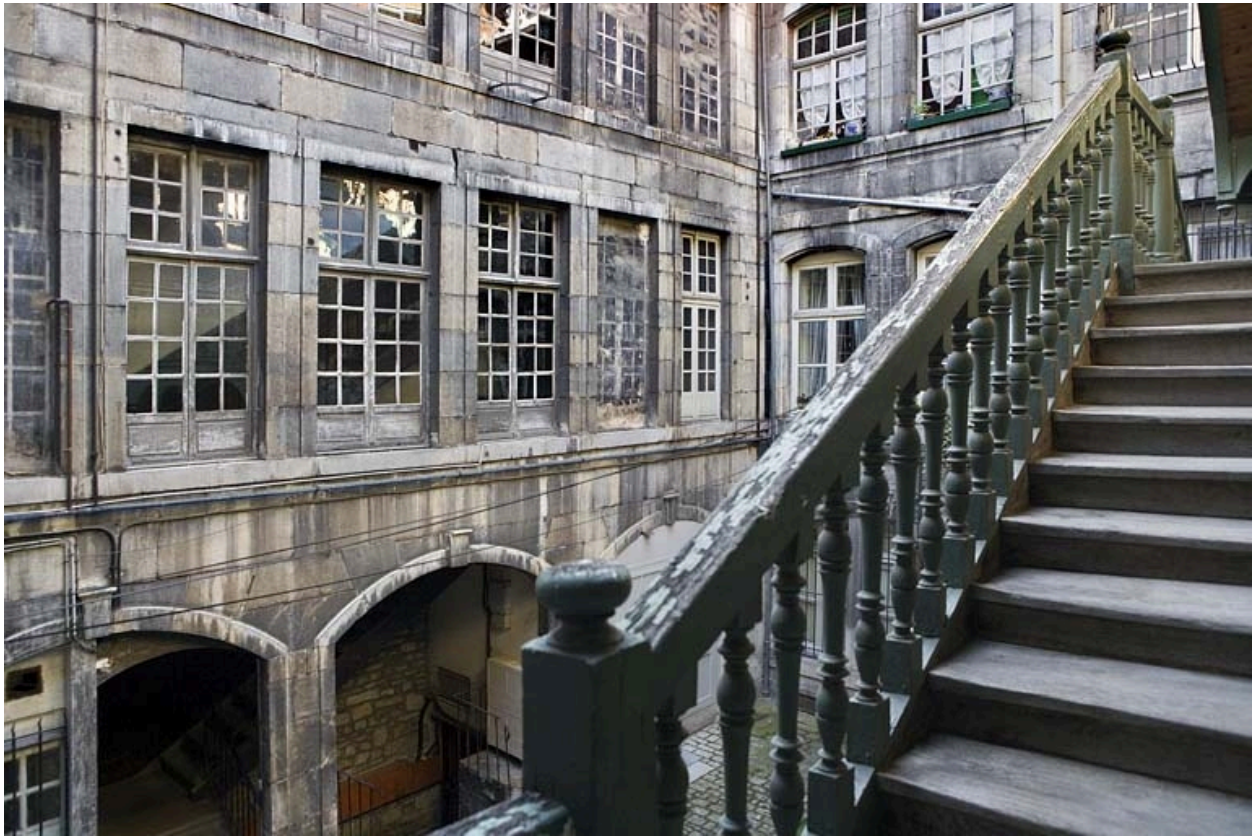
Aile gauche dans la première cour : détail du rez-de-chaussée et du premier étage.
