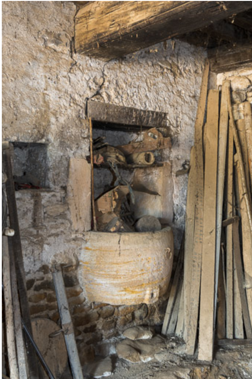
Cuvier à lessive dans l'ancienne maison n°3 (A 380), partiellement reconstruite et entièrement transformée en remise.
