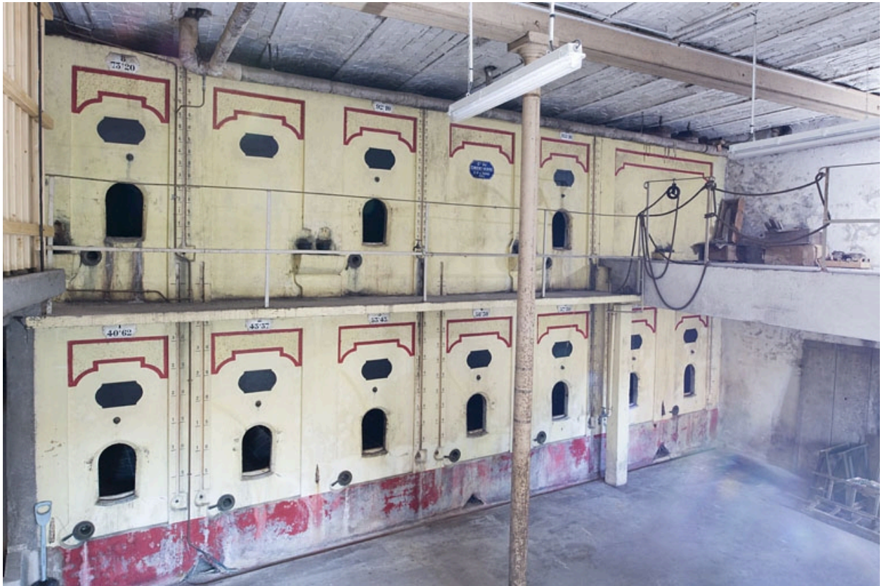
Intérieur de l'entrepôt : vue d'ensemble des cuves.
