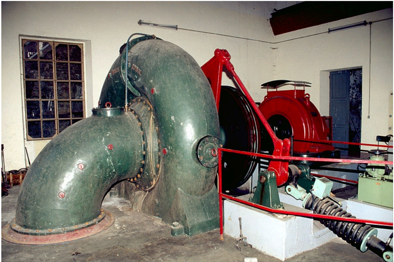
Vue rapprochée de la turbine n° 3.
