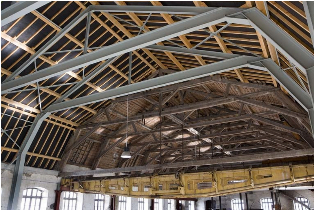
Atelier de préparation de la pâte. Reprise contemporaine de la charpente par fermes métalliques.
