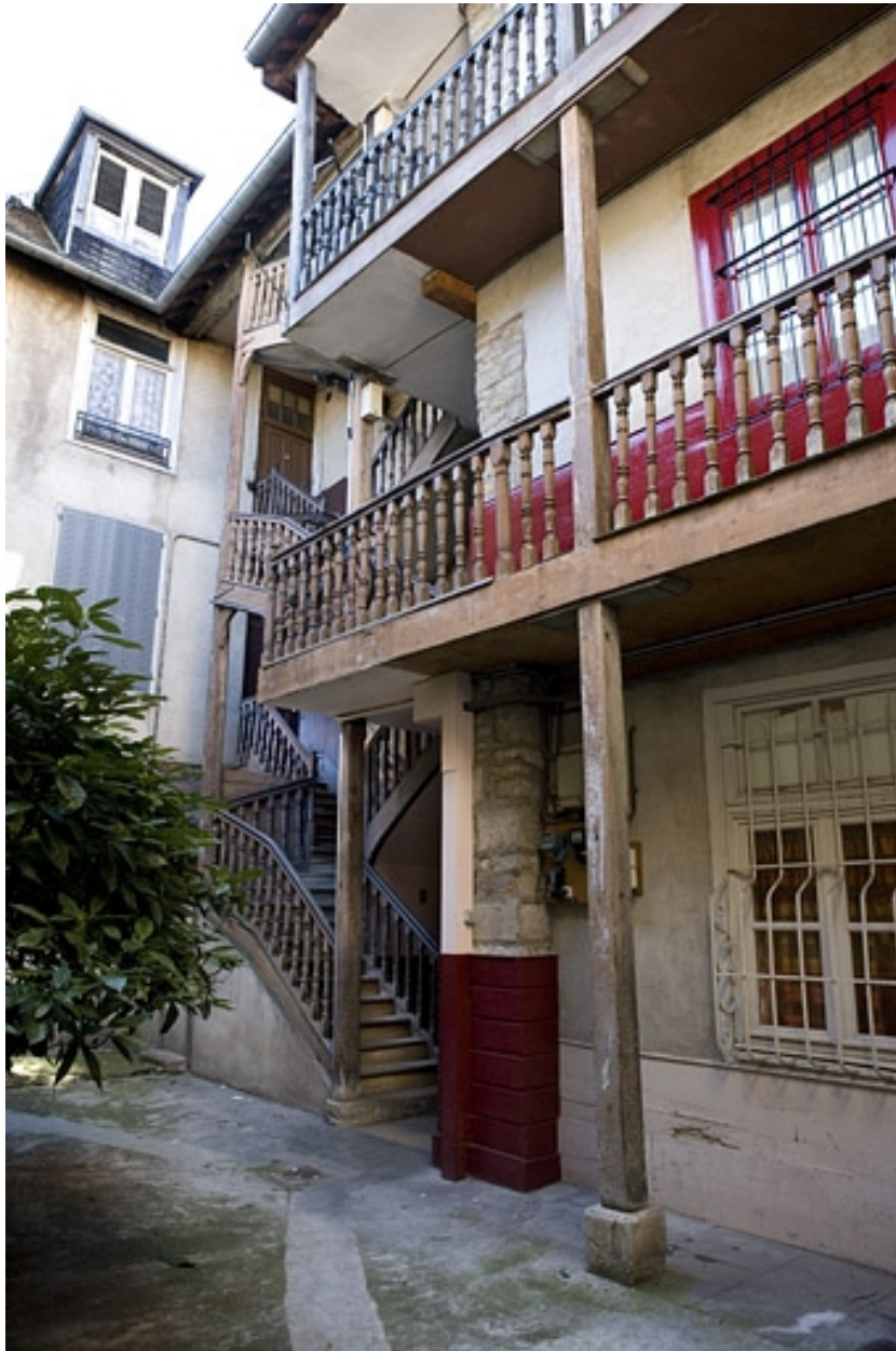
Vue d'ensemble de l'escalier à cage ouverte et des coursières depuis la cour.
