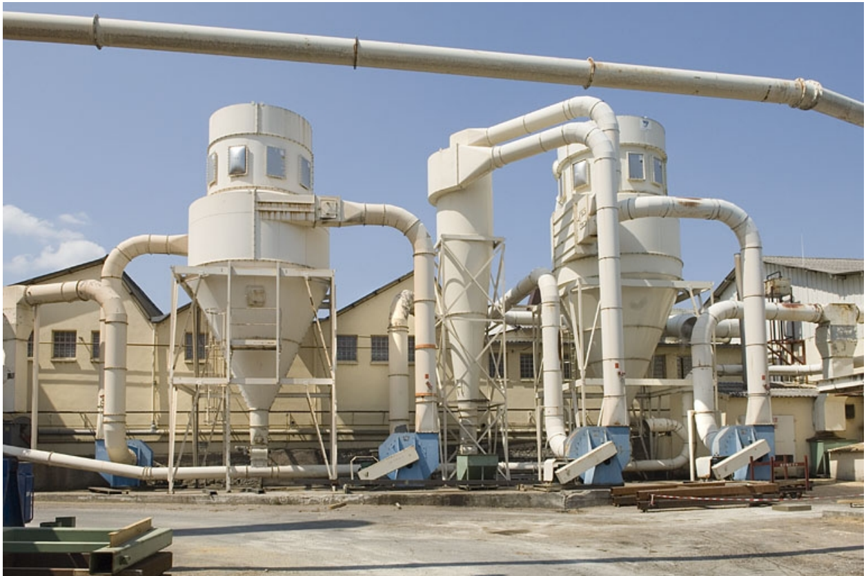
Installation de traitement de la sciure.
