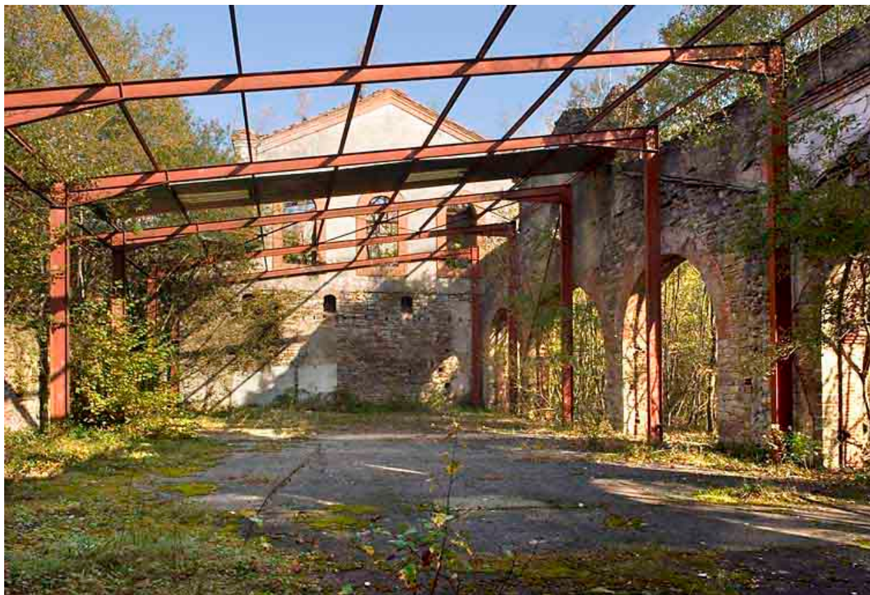
Salle des chaudières.
