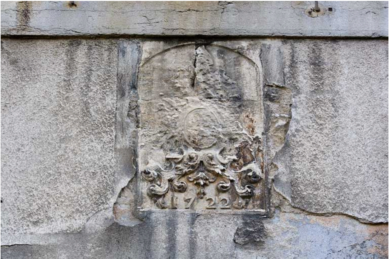
Détail d'un blason bûché daté 1722 sur une baie du rez-de-chaussée.
