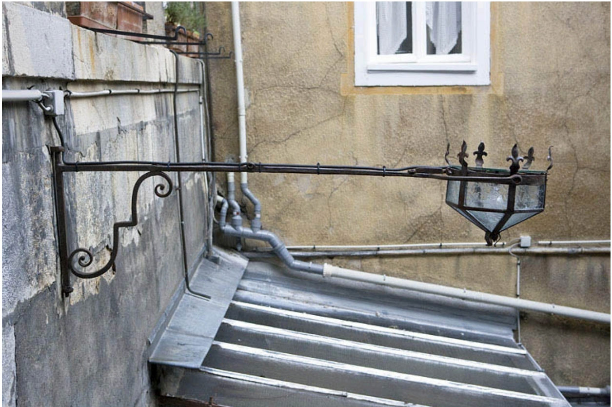
Détail du bras de lumière sur la façade postérieure du logis principal.
