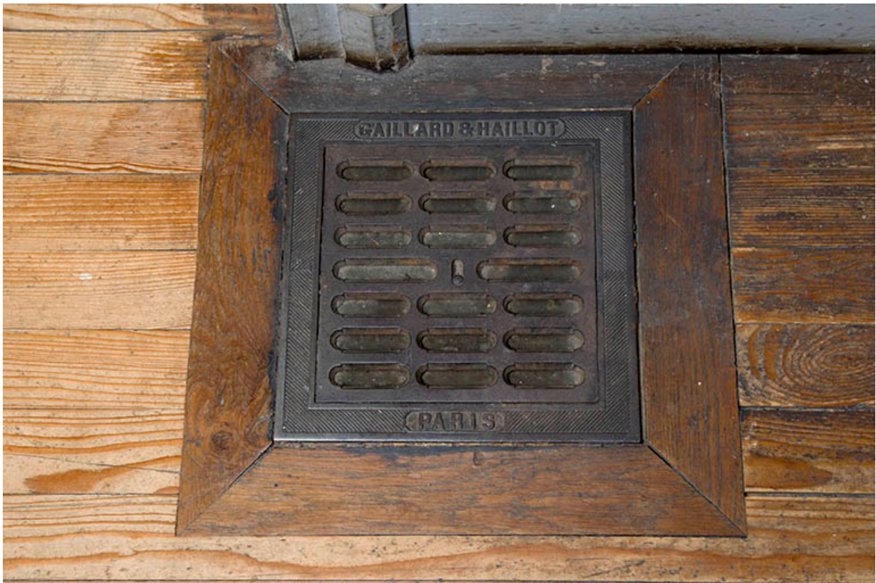
Grille de ventilation du chauffage central.
