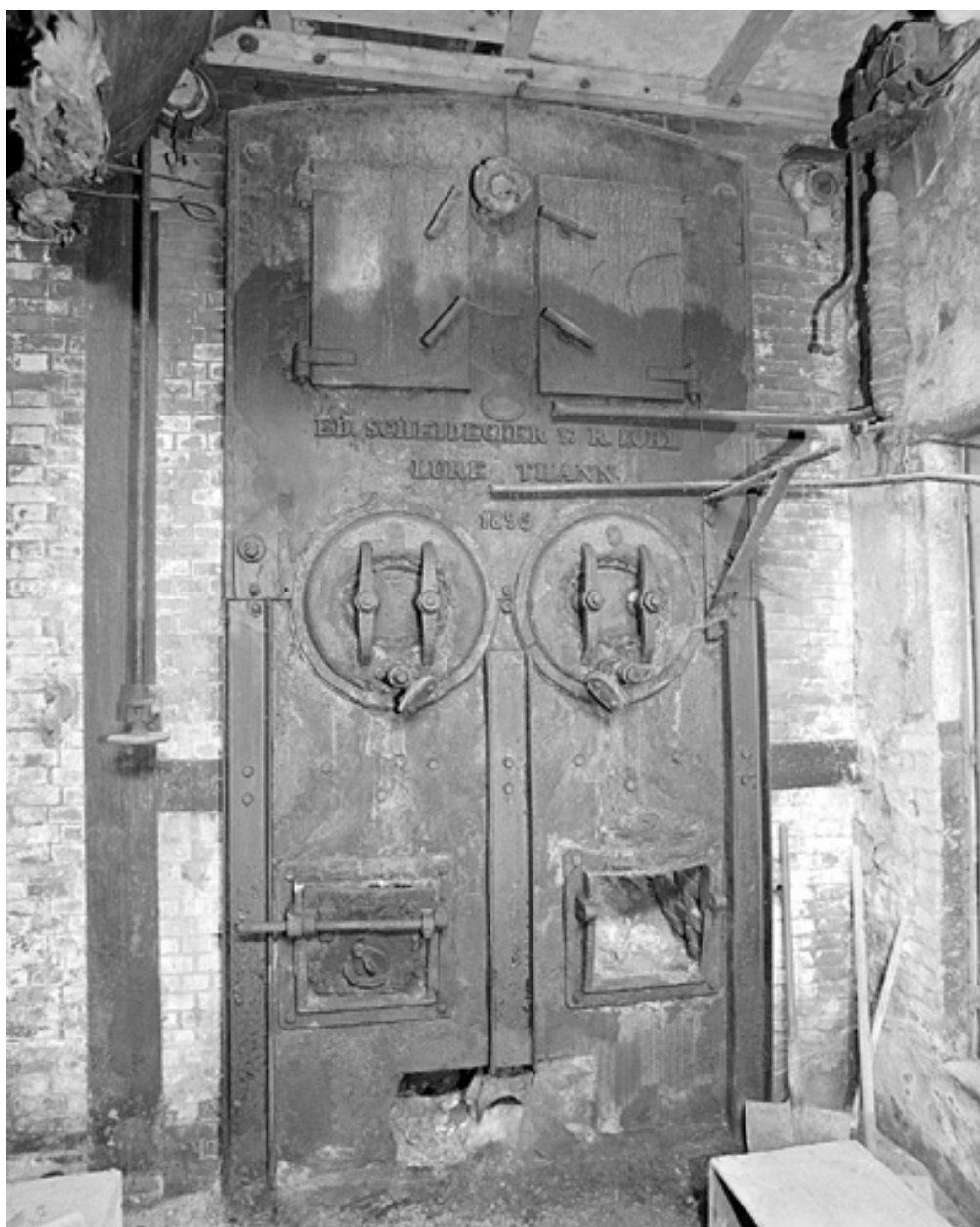
Chaudière de la machine à vapeur.
