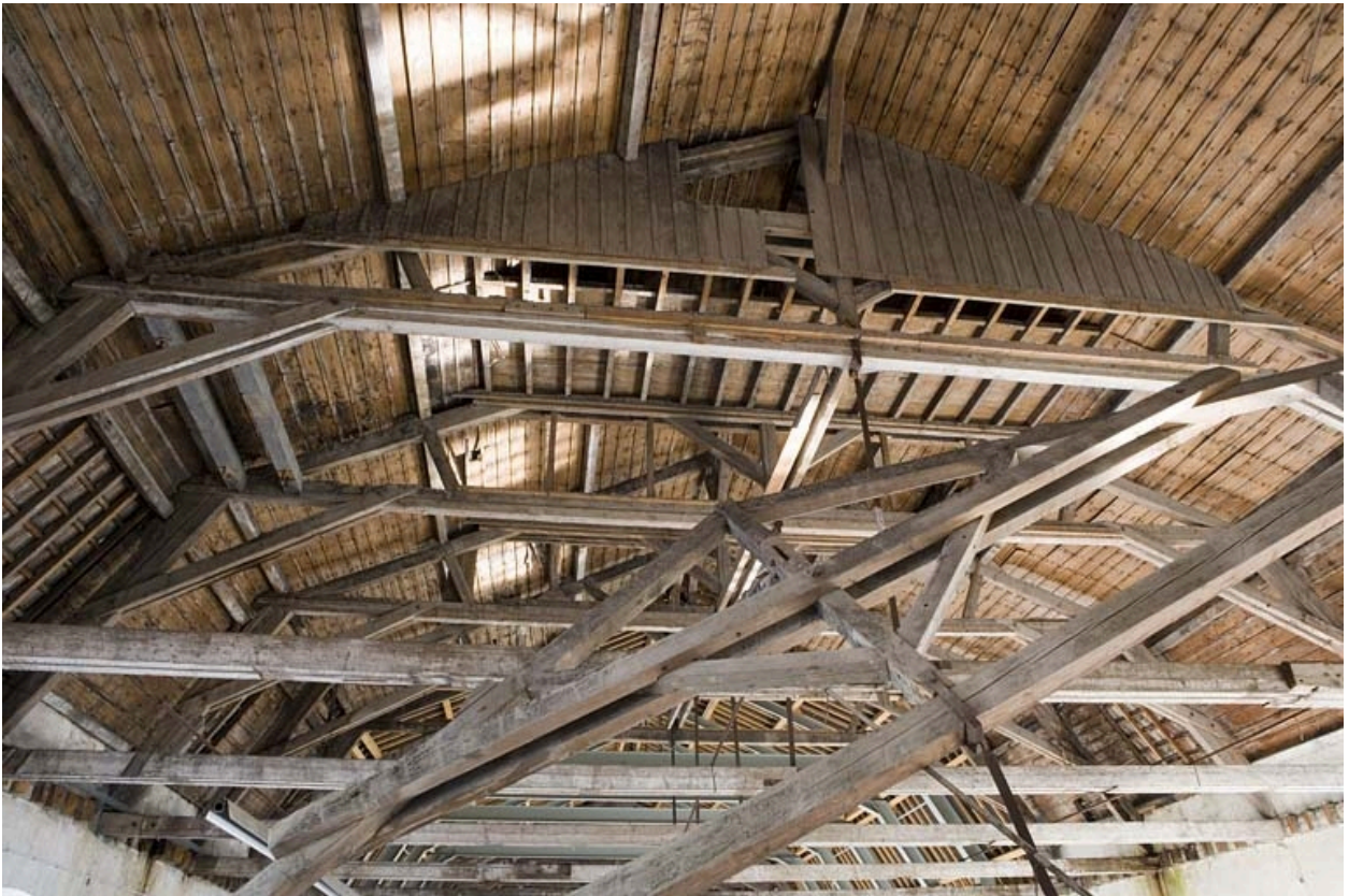
Atelier de préparation de la pâte. Éléments de la charpente (ferme effondrée au premier plan).
