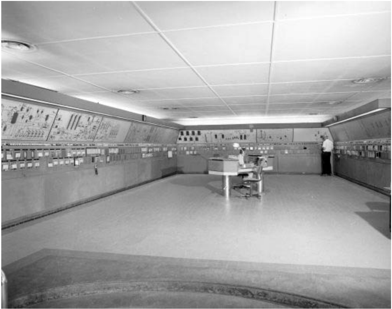
Intérieur de la salle de contrôle de l'aire de fabrication de l'eau oxygénée (21).
