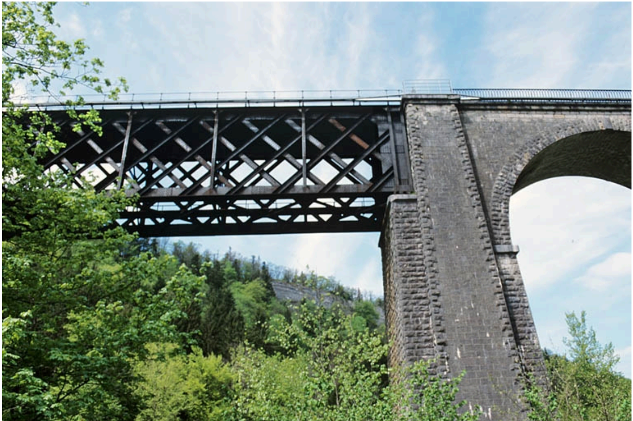
Jonction de la travée métallique et de l'arche en maçonnerie, rive droite.
