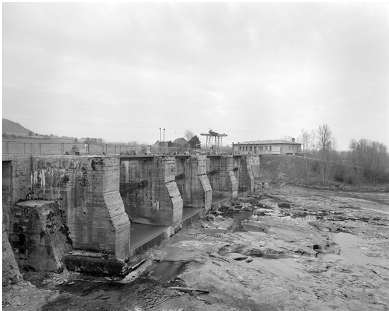
Barrage et vannes-secteurs.
