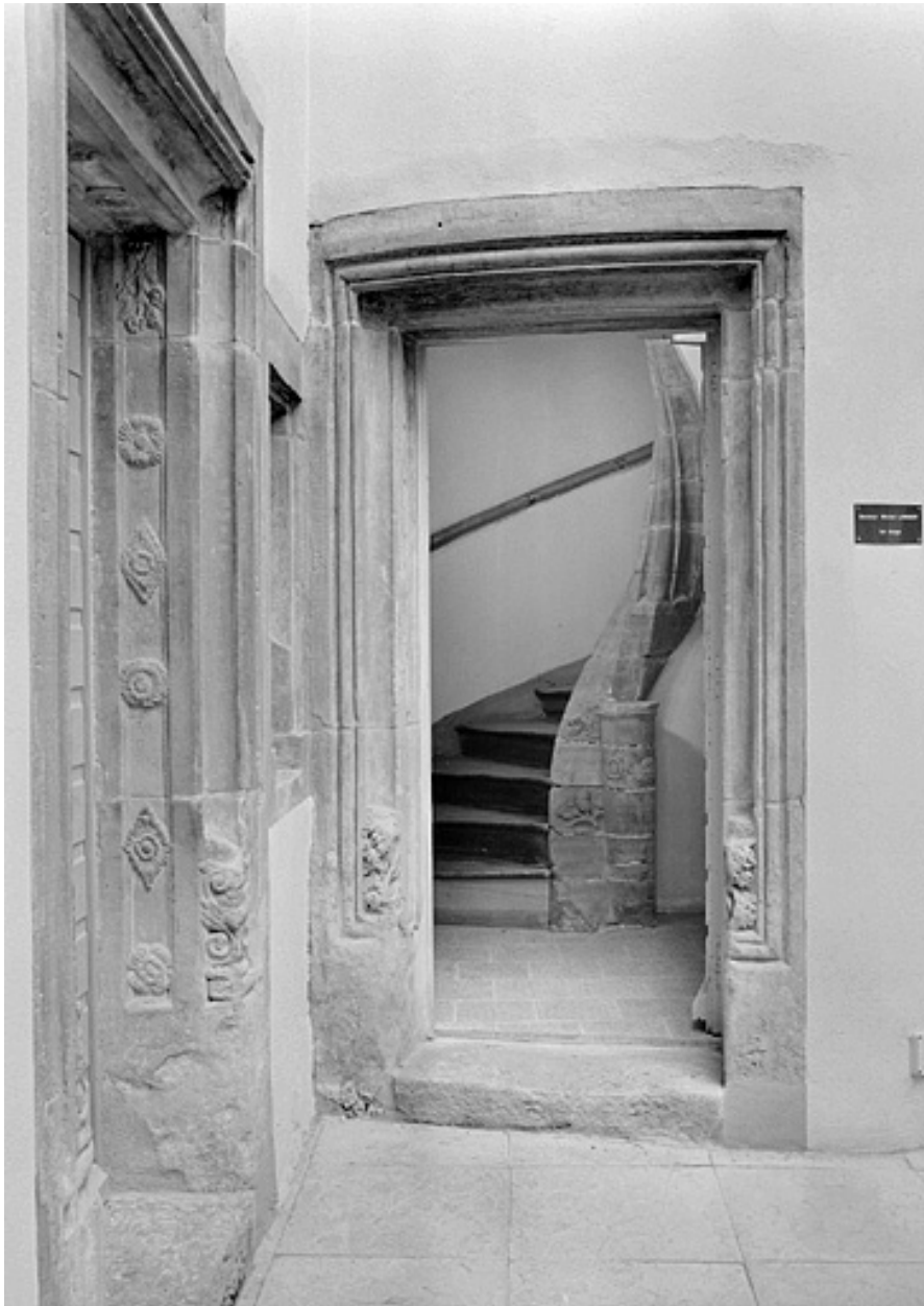
Maison 11, rue de la Sous-Préfecture. Portes. Fin 15e ou début 17e siècle. Porte de l'allée à gauche et porte de la tour d'escalier à droite.
