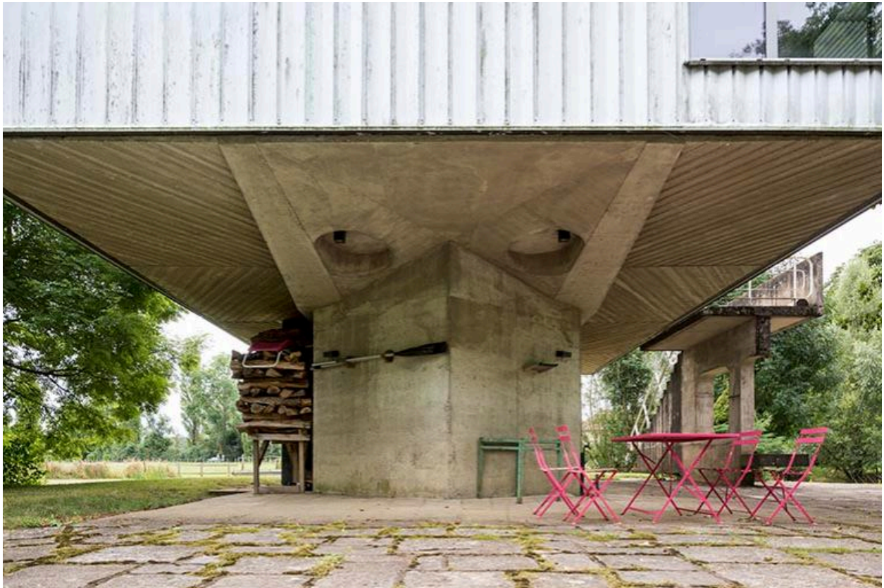
Vue de la pile et du soubassement avec alvéoles aménagées, façade nord
