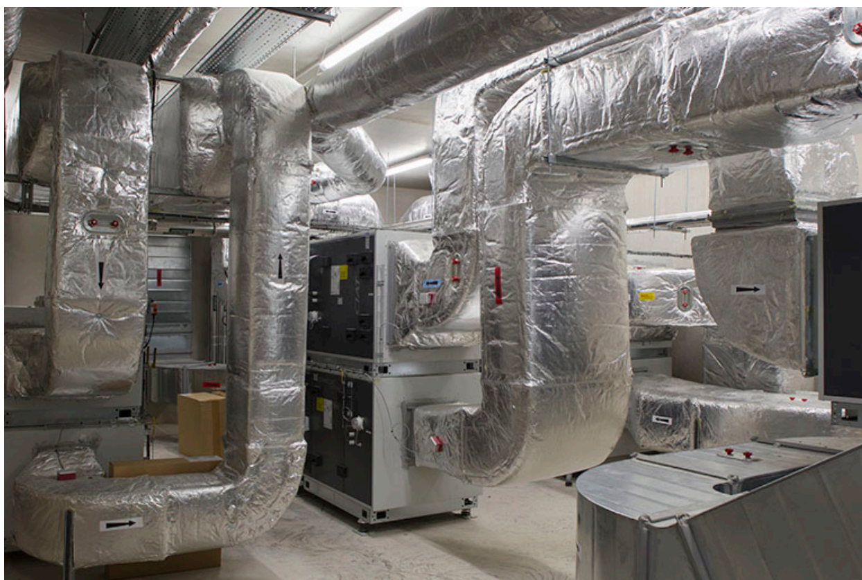
Machinerie d'extraction d'air du p le h telier.
