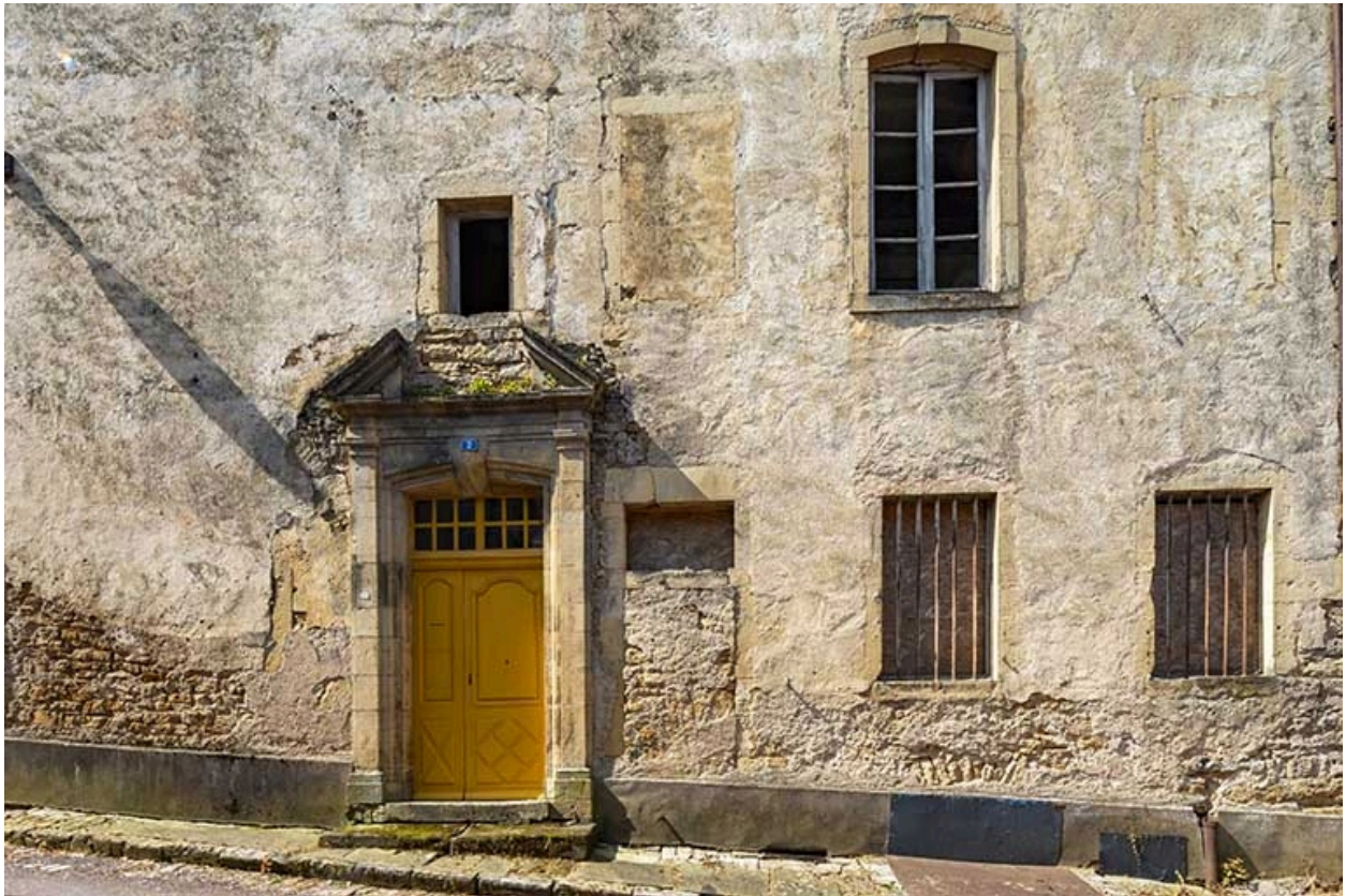
Détail de la façade orientale et de la porte située à la base de la tour.
