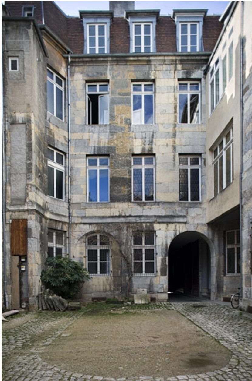
Vue d'ensemble des façades sur cour depuis le fond de la parcelle.
