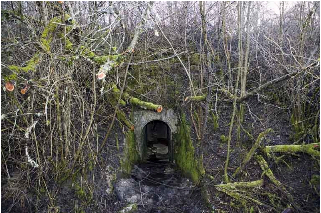
Réservoir, Pâturage de Montsevely : aqueduc d'évacuation.
