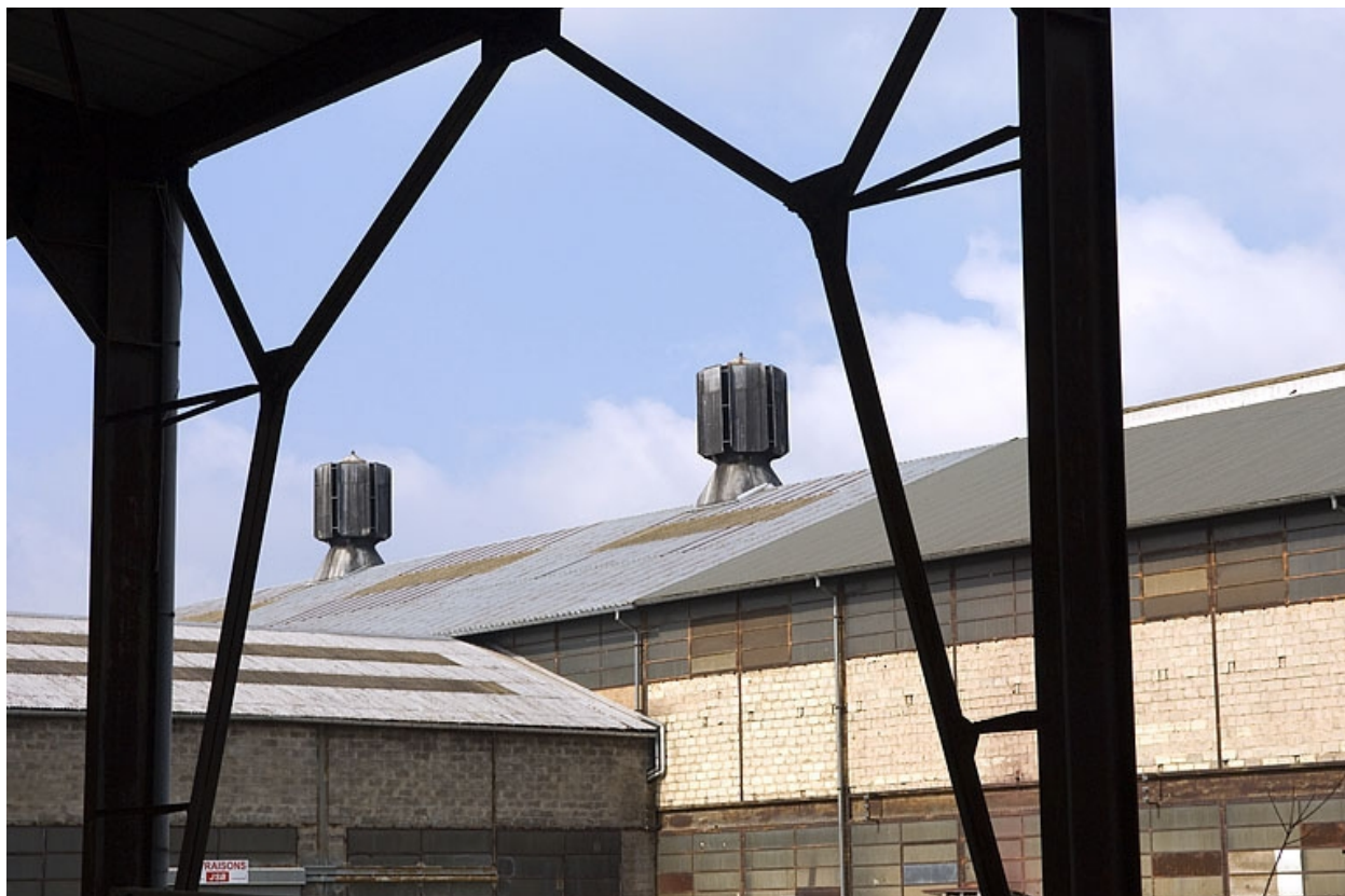
Atelier de fabrication. Cheminées d'extraction.
