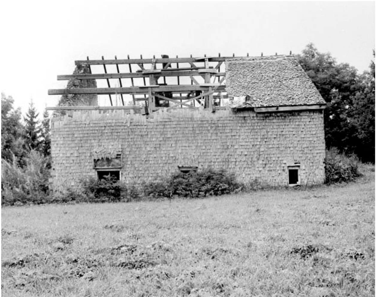
Les Bouchoux, ferme : vestiges de couverture en tavaillons.
