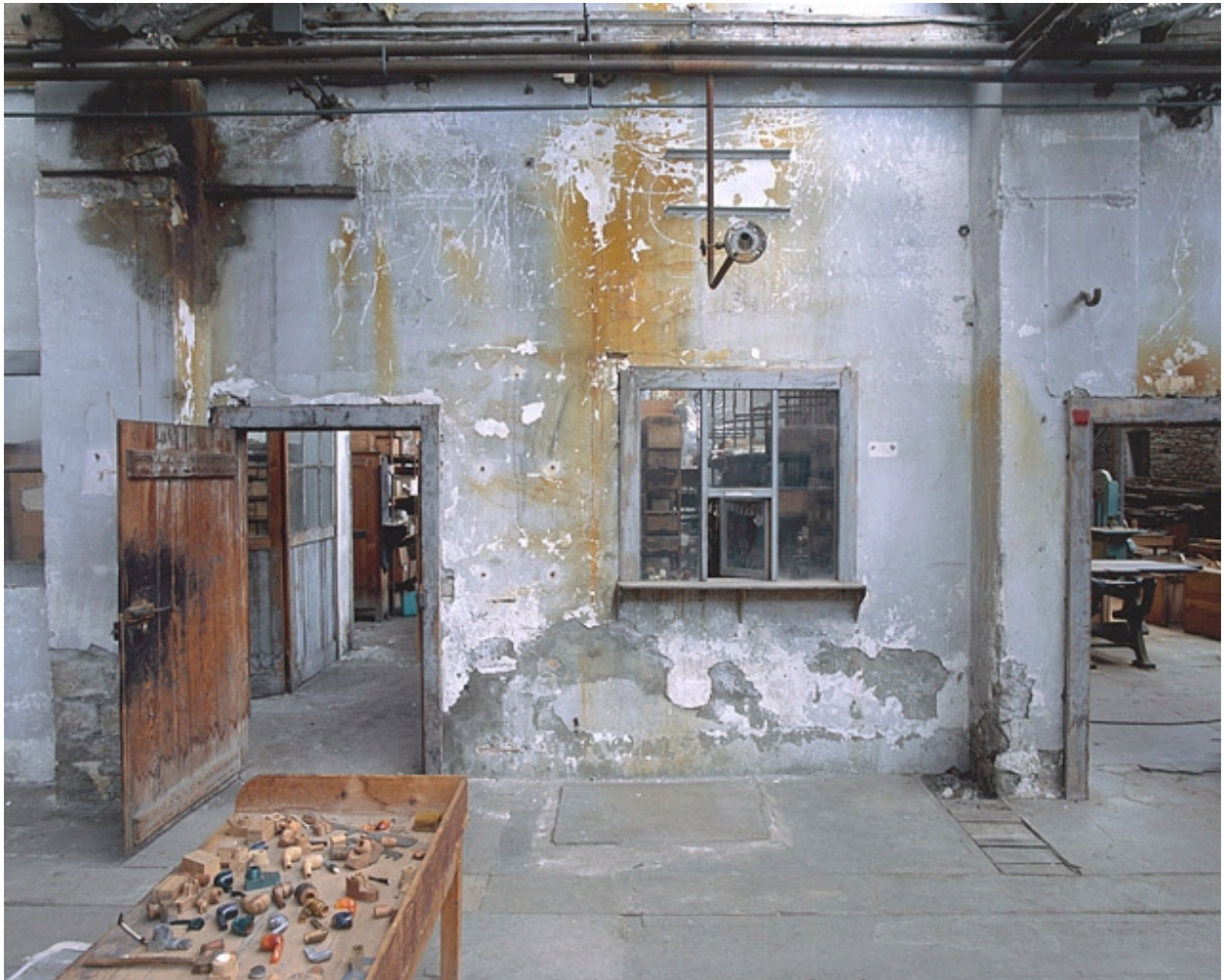
Mur ouest de l'atelier de fabrication de pipes : portes d'accès au magasin de fournitures.
