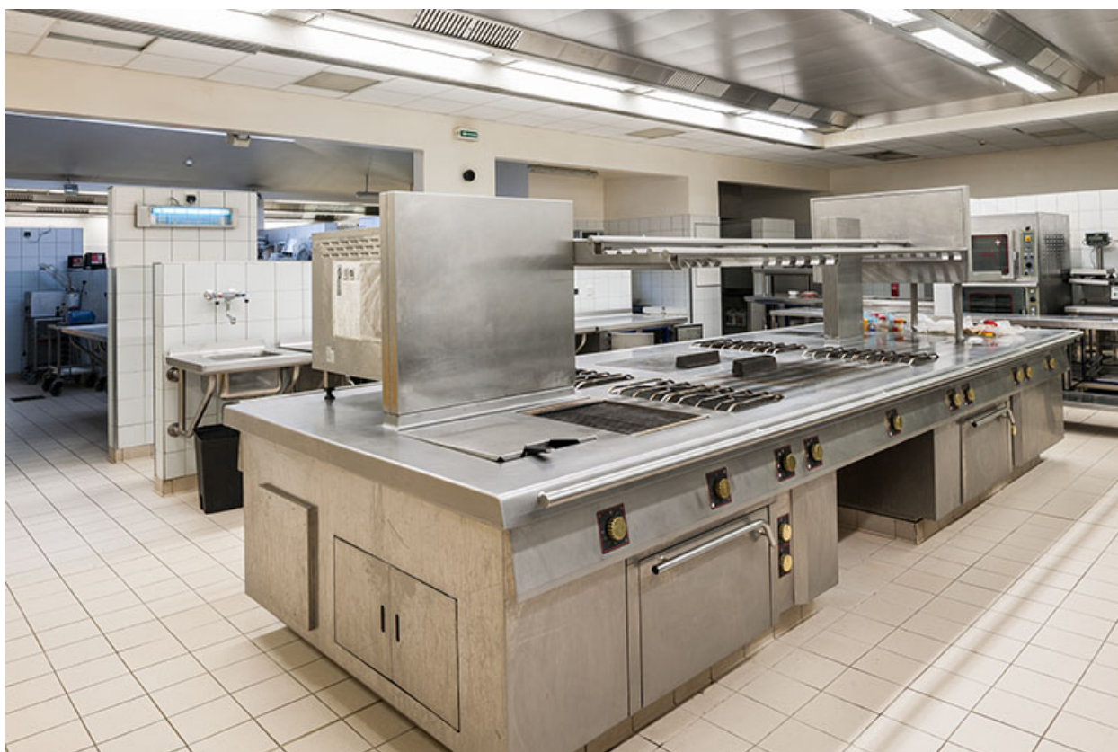
Cuisine du restaurant d'application.
