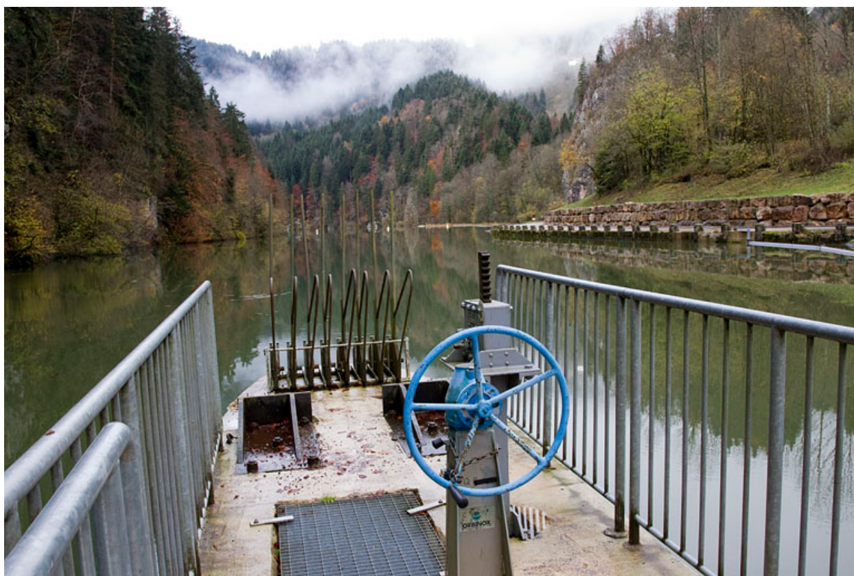
Barrage : commande de vanne de fond.
