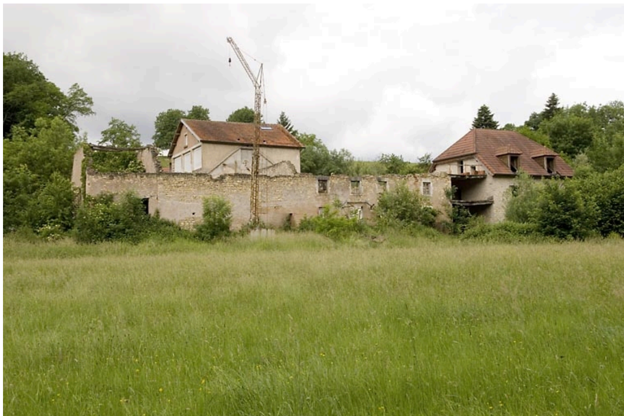
Bâtiment en ruine depuis l'est.
