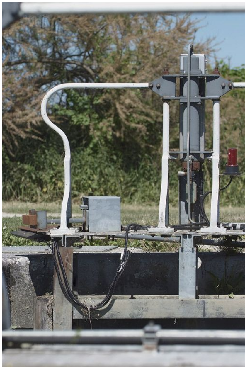
Détail du système d'automatisation des portes.
