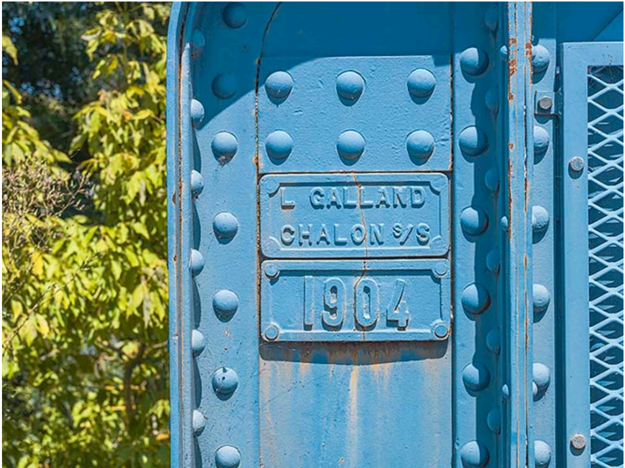
Détail du garde-corps du pont avec le nom de l'entrepreneur et la date.
