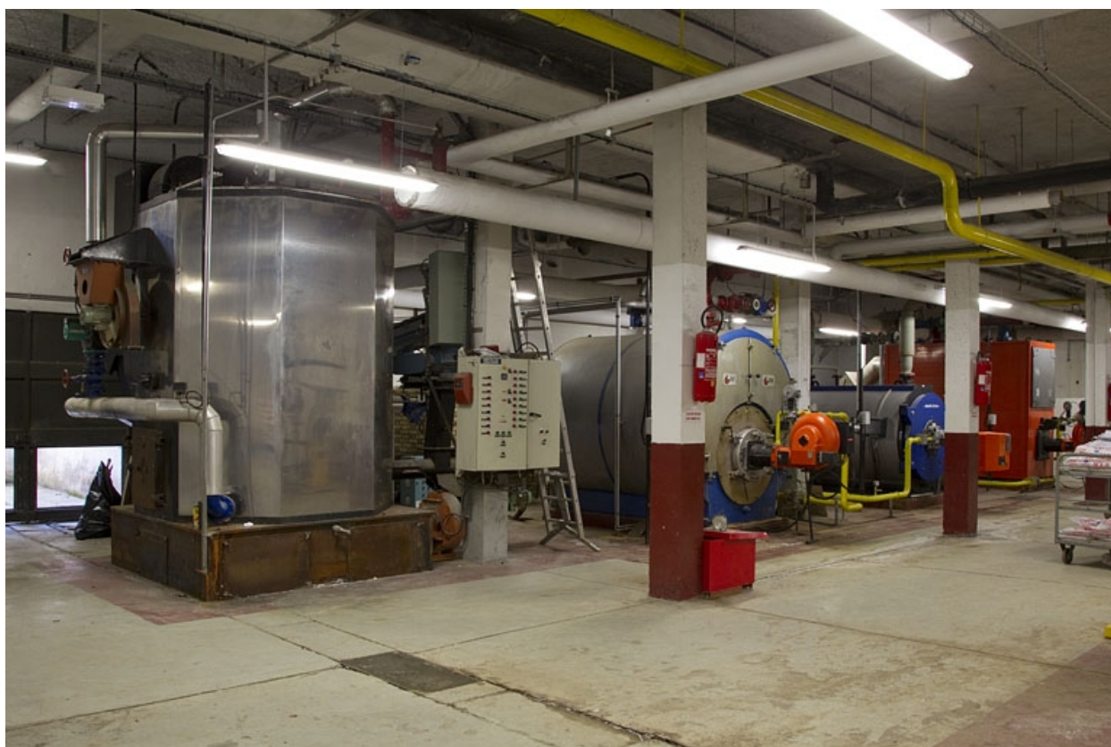
Bâtiment de l'internat ouest, chaufferie : les chaudières.
