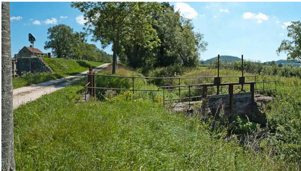
Vue des vannes de prise d'eau.
