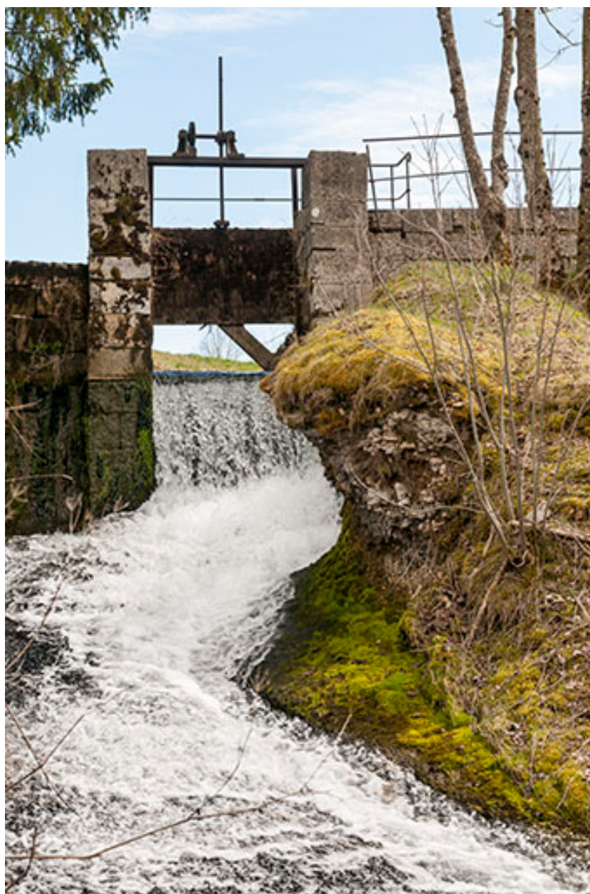
Vanne de décharge sur le Bief Rouge.
