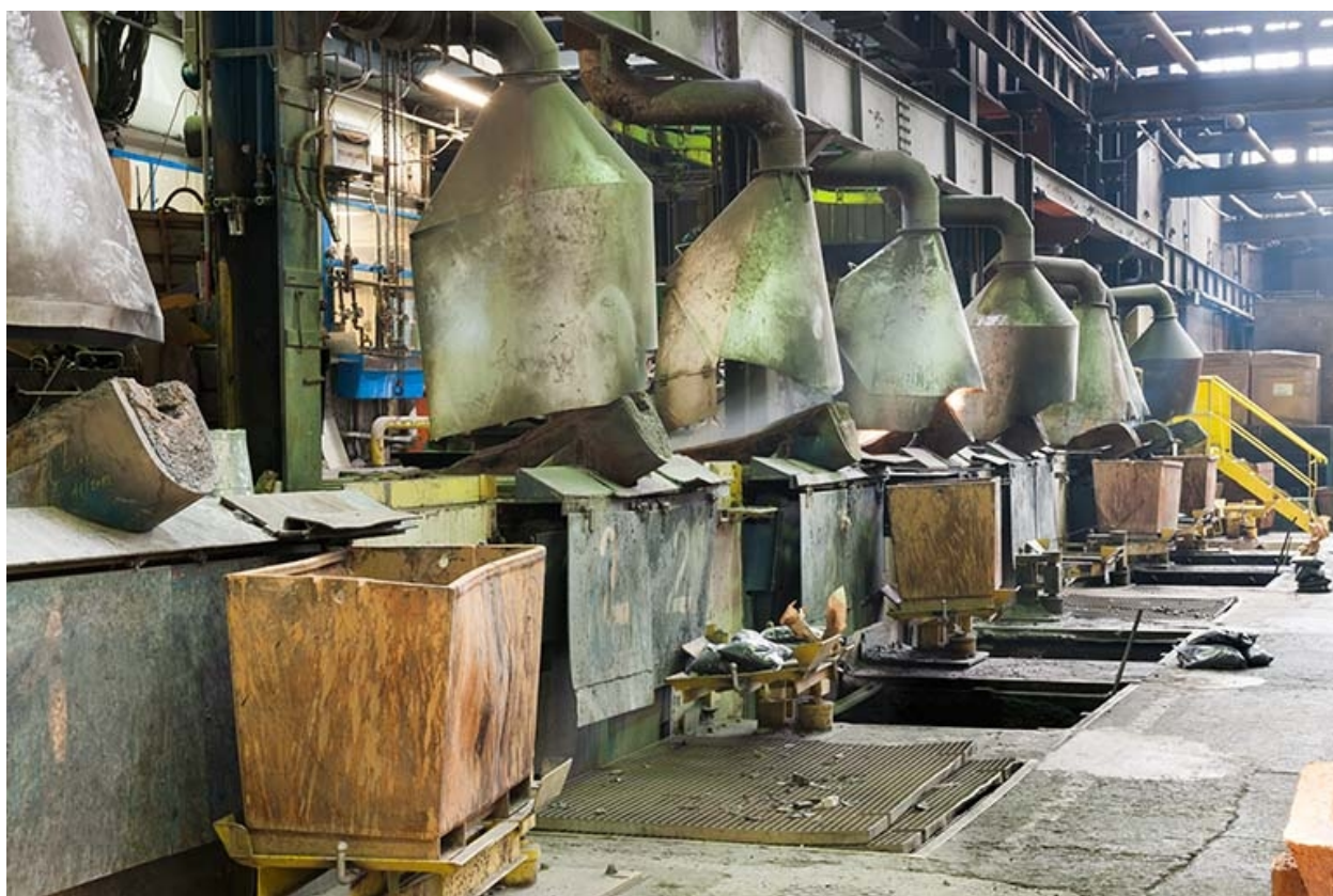
Batterie de fours à induction (1).
