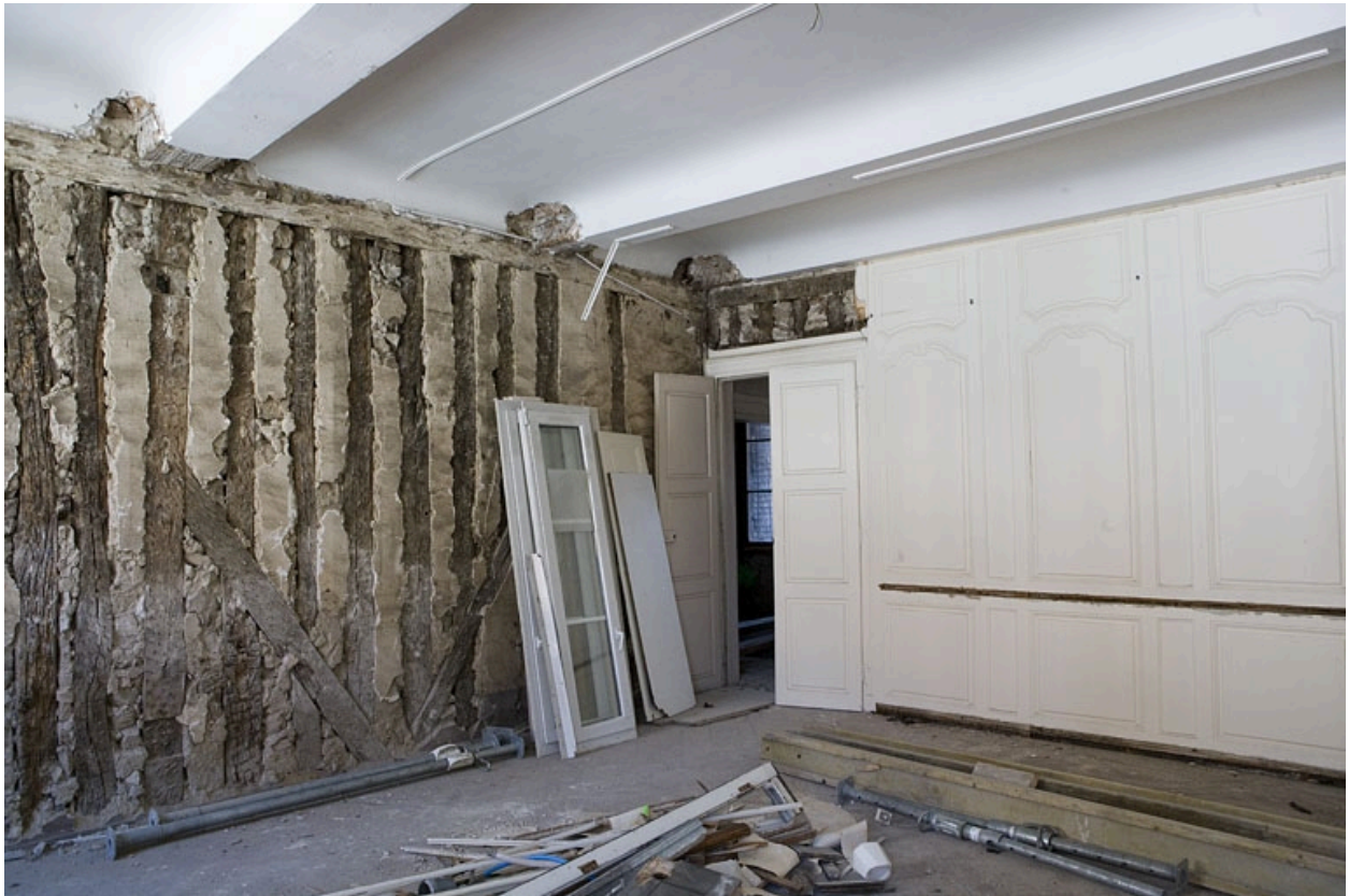
Intérieur, premier étage : détail d'un mur d'une pièce avec les lambris déposés.
