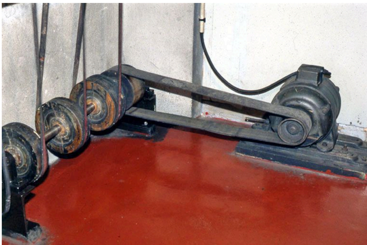
Moteur électrique Roulland et arbre de transmission.
