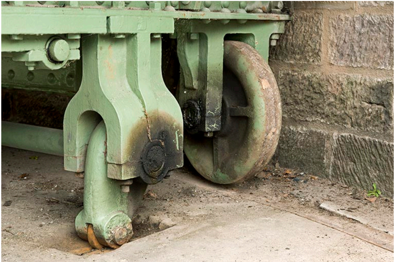
Système de calage baissé (côté amont).
