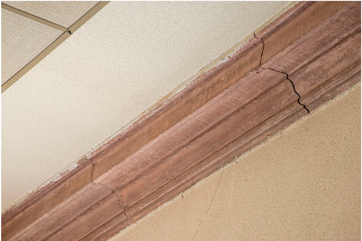
Piscine à l'emplacement du Bain des Dames, détail de l'adoucissement mouluré du plafond.
