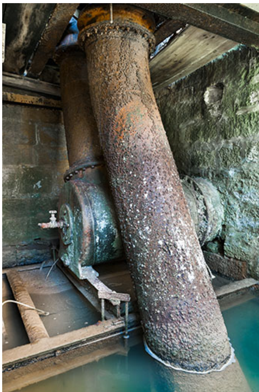
Turbine hydraulique (partie inférieure).
