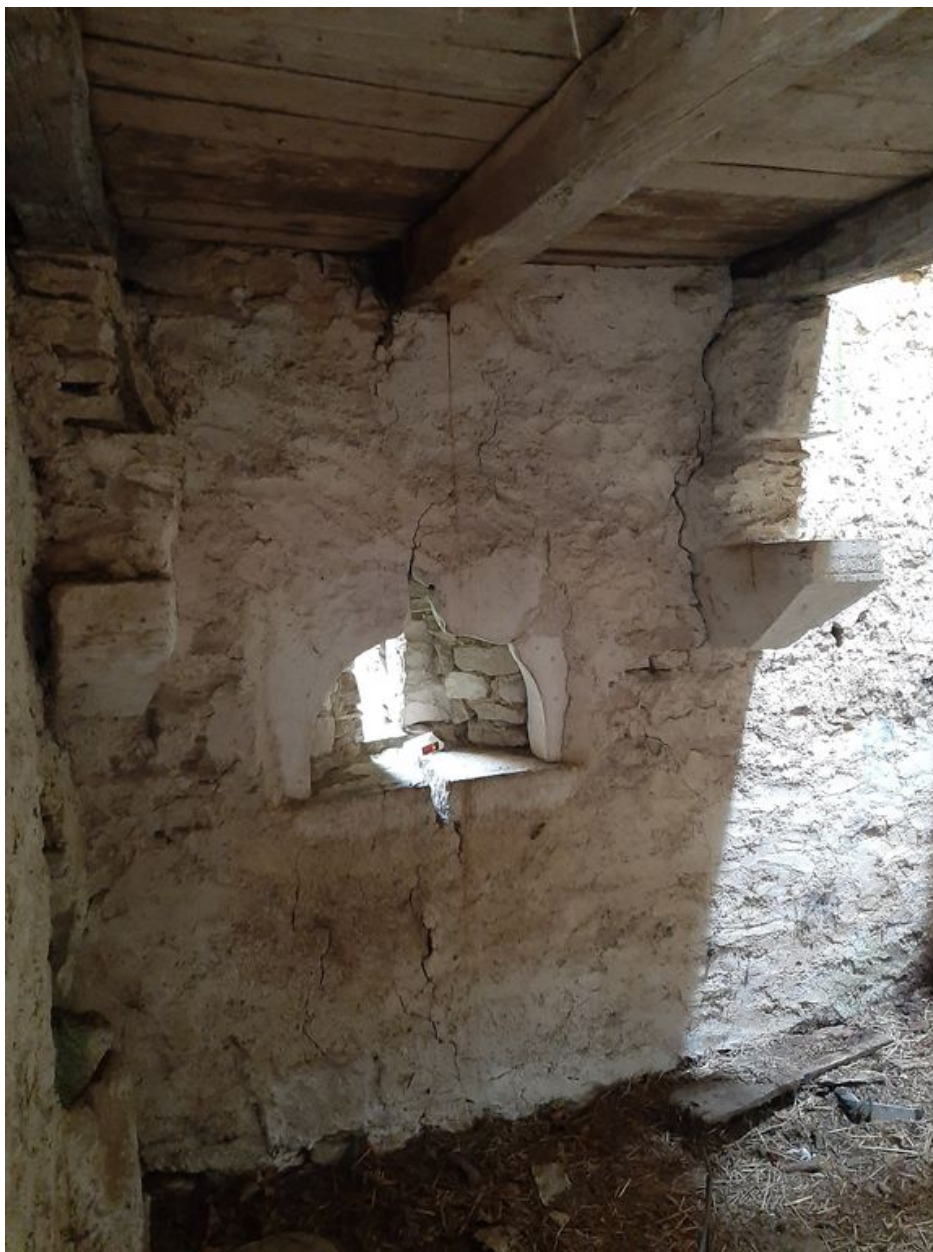
Détail de la gueule du four à pain.
