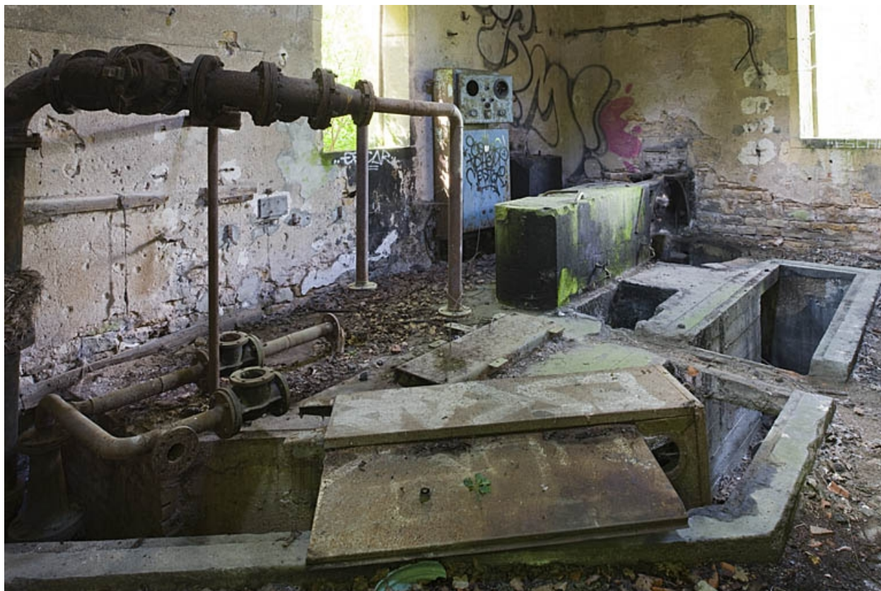
Station de pompage : vue rapprochée de l'intérieur.
