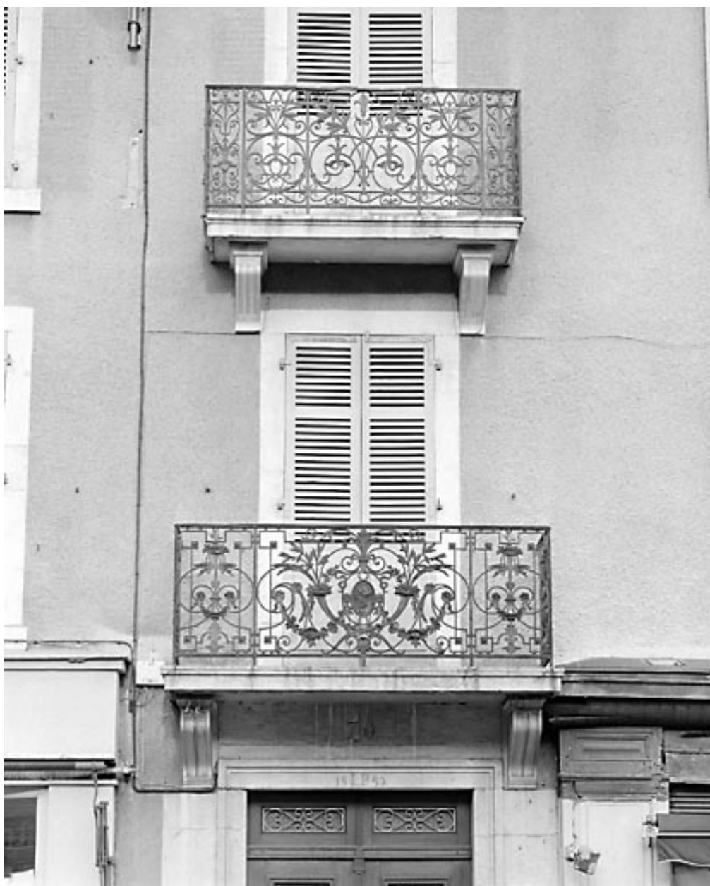
Balcons surmontant la porte d'entrée, avant restauration.
