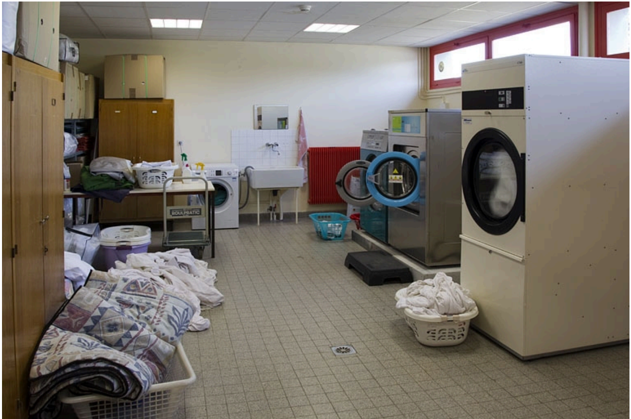
Bâtiment de l'internat ouest, lingerie : les machines à laver et à sécher.
