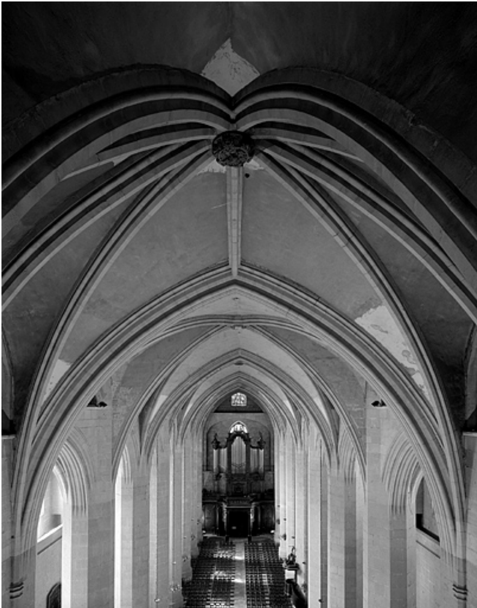
Voûtes de l'abside et du vaisseau central depuis la travée d'axe de la coursière haute.
