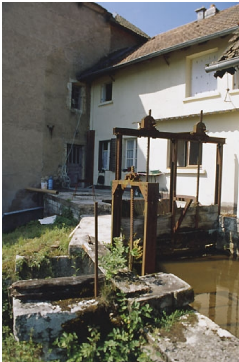
Vannage sur le canal d'amenée.
