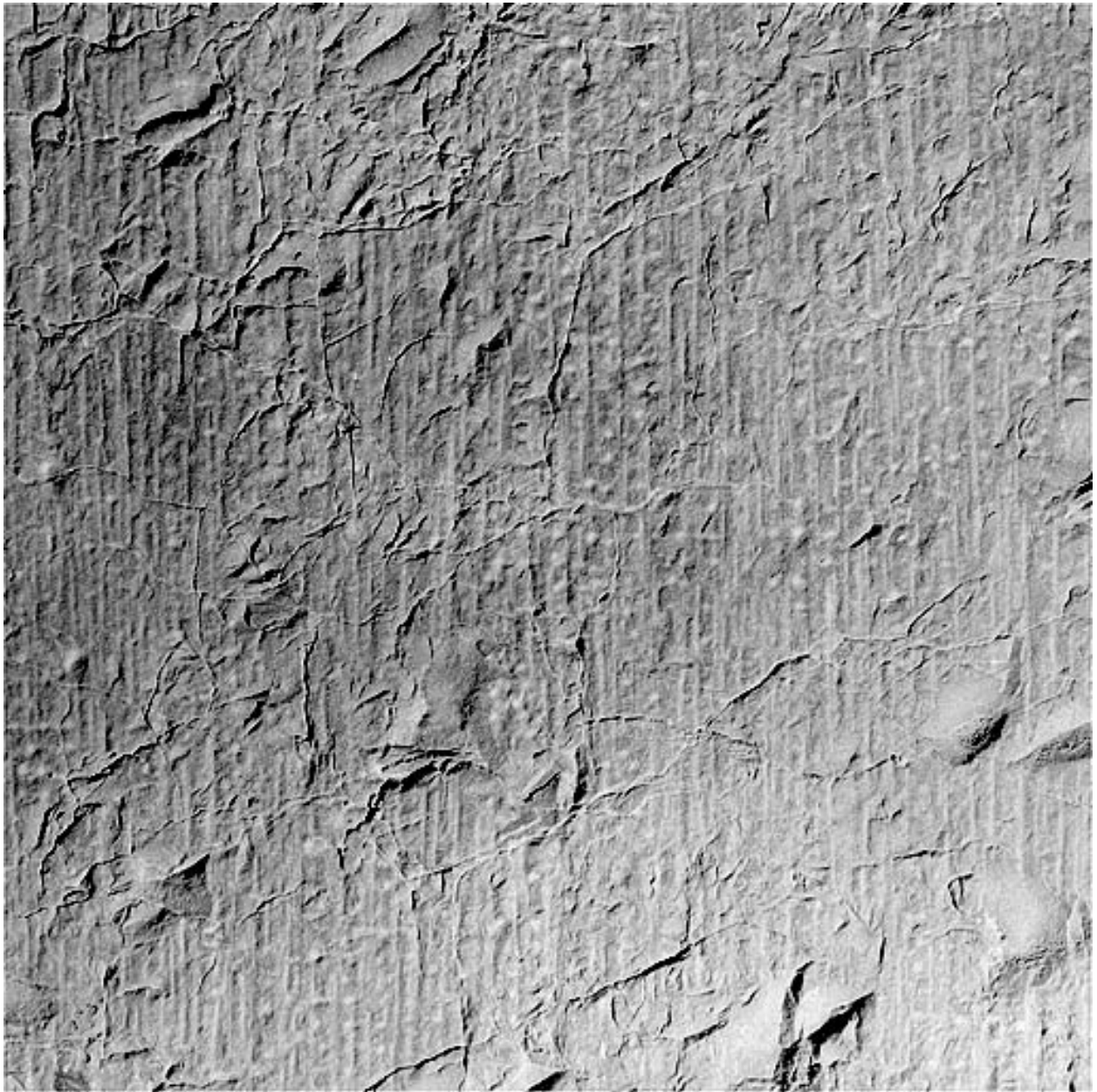
Traces de boucharde et de laie sur la pile VIIS.
