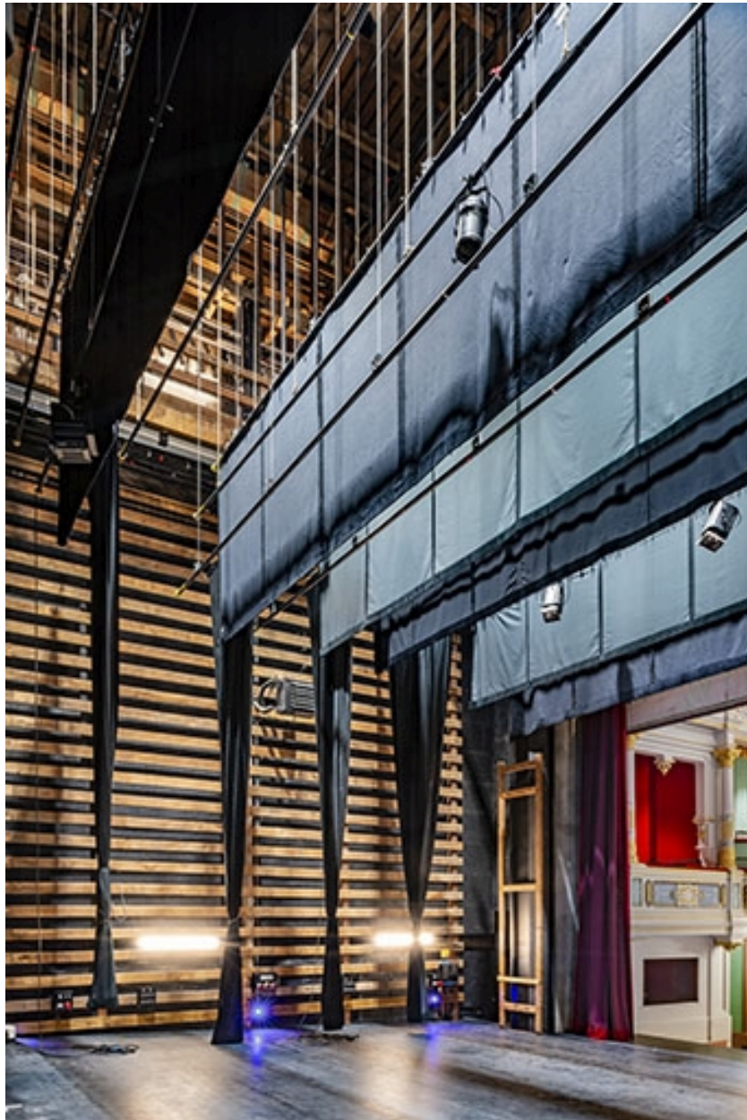
Cage de scène : cheminée de contrepoids côté cour, pendrillons et frises.
