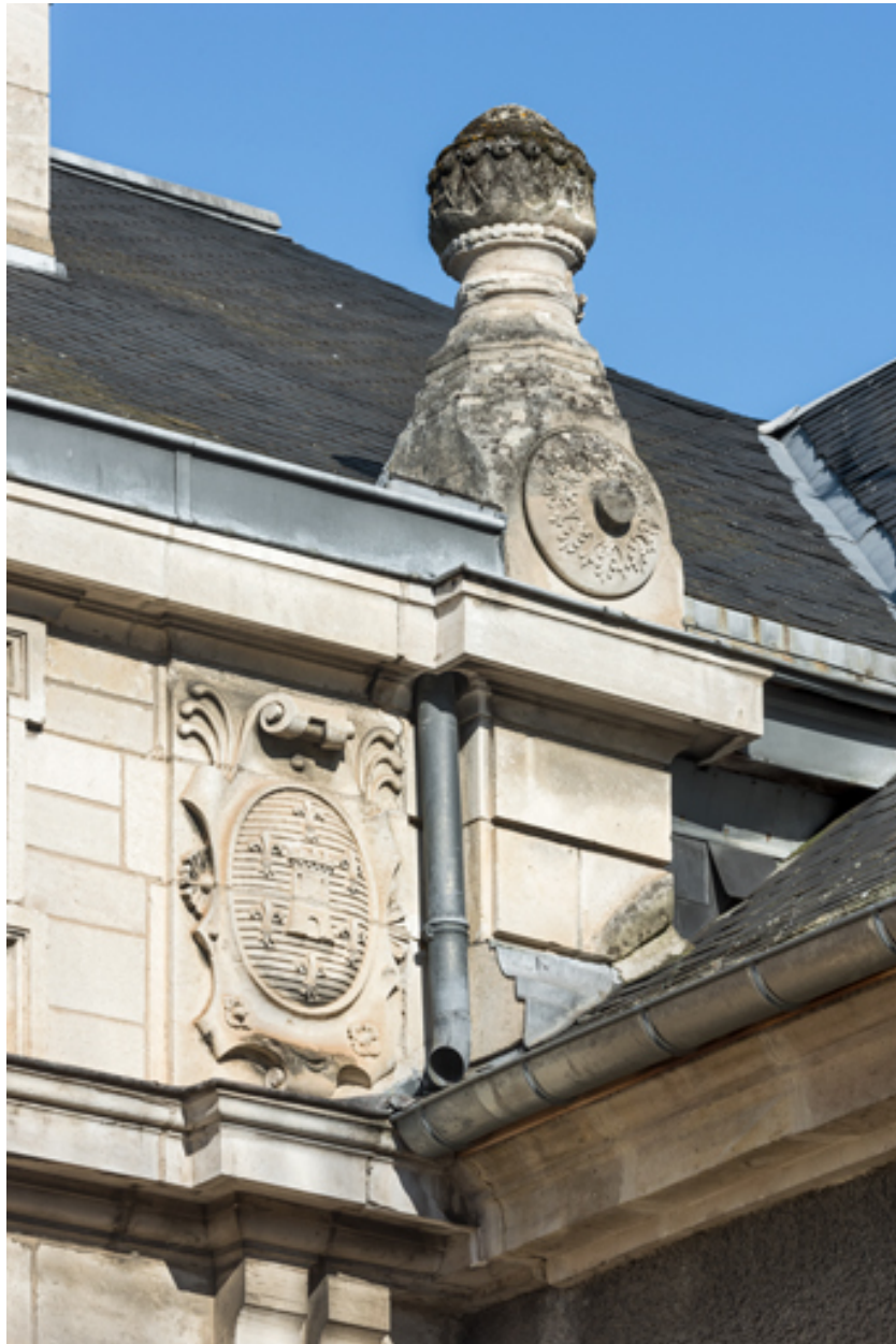
Façade latérale droite, attique : armoiries de la ville et amortissement sur l'angle droit.
