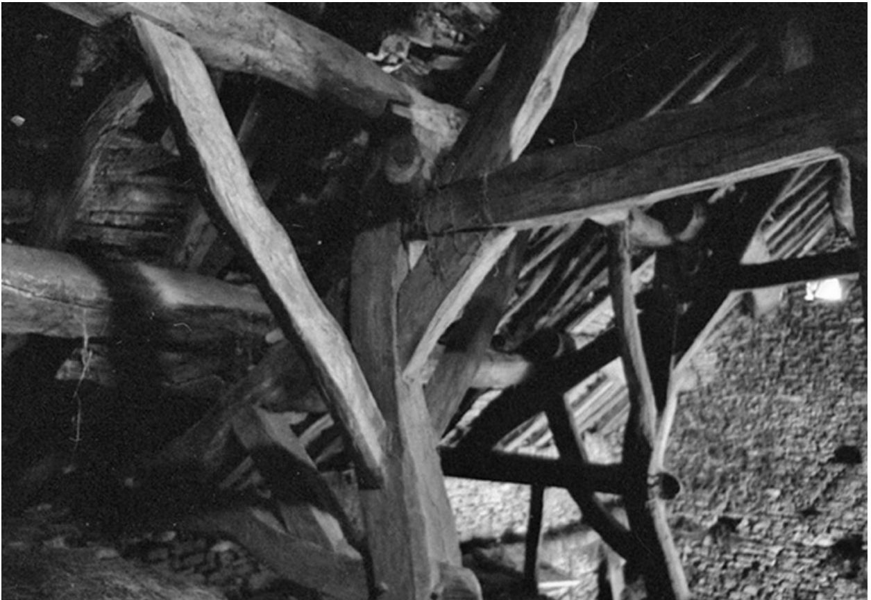
Ferme cadastrée 1960 B 107, située au lieudit La Peyrouse : détail de la charpente d'un toit en laves.
